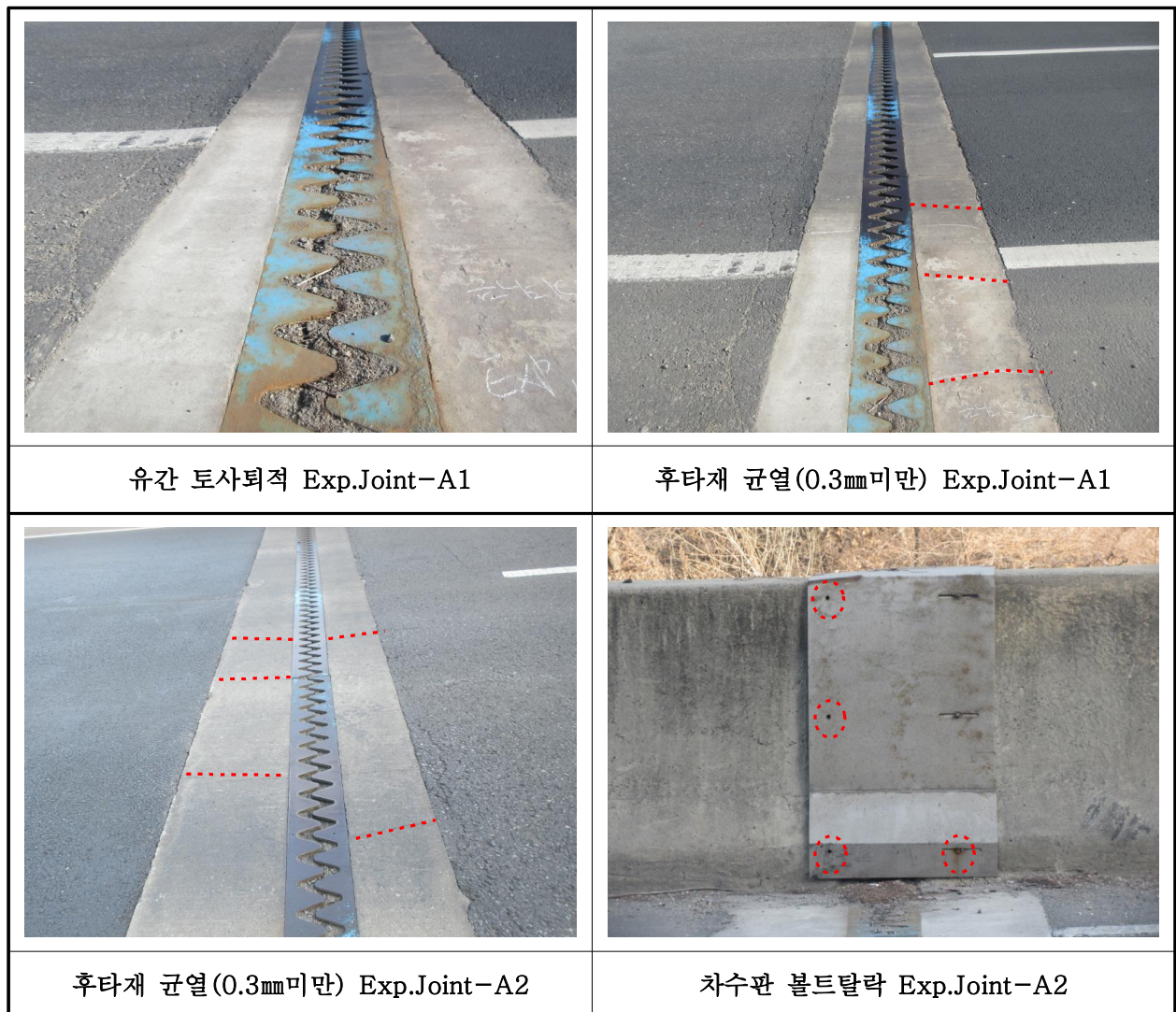
【사진 1.3.15】 신축이음장치 손상현황
