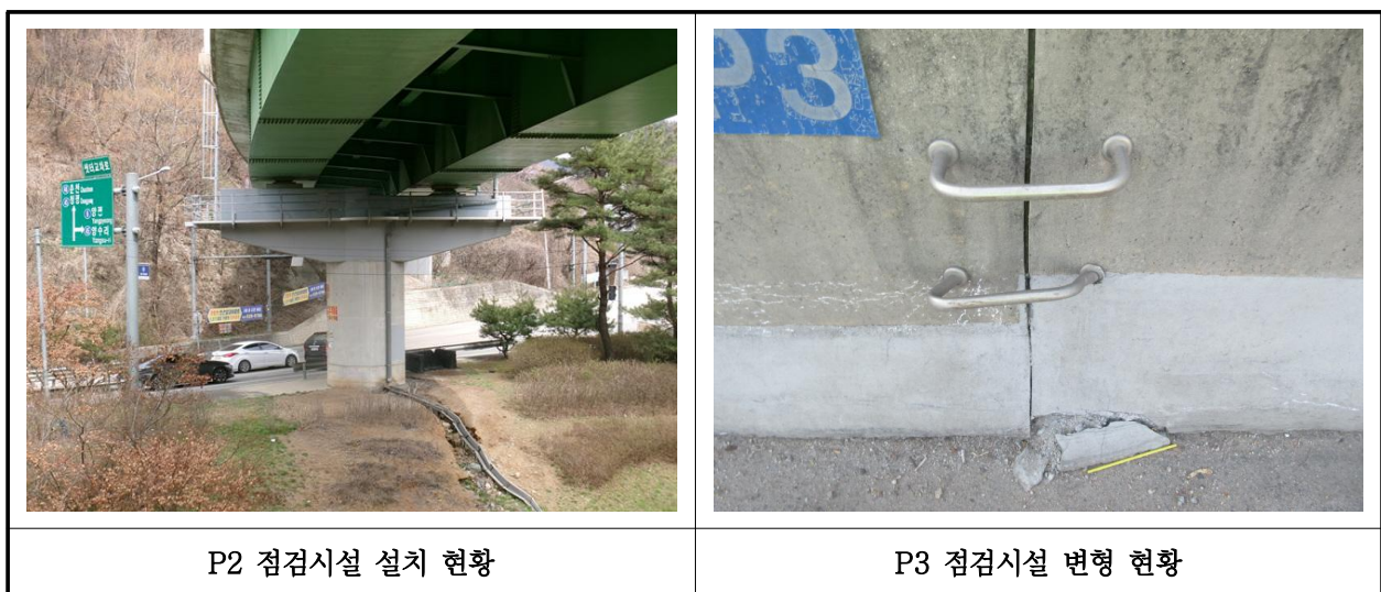
【사진 1.7.3】 점검시설 설치현황
